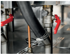
Sistema de drenaje conectado directamente al alcantarillado.
