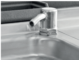
Grifo acoplado para el abastecimiento de agua.
