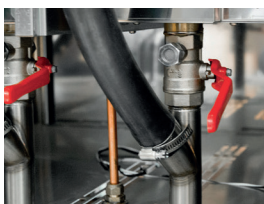
Sistema de escoamento conectado diretamente ao esgoto.
